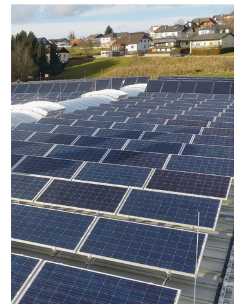
Im Vordergrund: PV-Anlage, Im Hintergrund: Die gesamte Solarthermie
